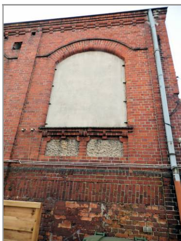
Przykład detali architektonicznych w najmniej zniszczonej części budynku (okno prawdopodobnie zamurowane, pierwotnie otwarte)
